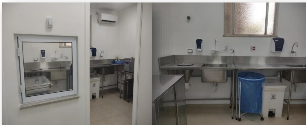
Figura 1: Expurgo da CME –Setor de limpeza de materiais contaminados
